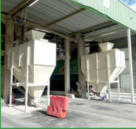
Nuevas tolvas automáticas para evitar contaminaciones cruzadas en la carga de camiones
