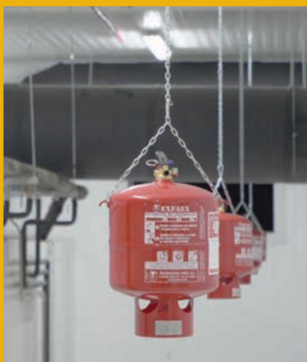
Sistema antiincendios de la incubadora de Marcilla
