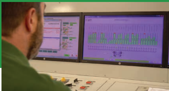
Pantalla que muestra la cantidad de producto en cada silo
