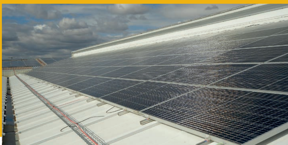
Placas solares instaladas en el tejado de la incubadora de Marcilla
